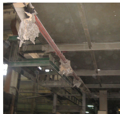
Ryc. 1. Fragment nieizolowanego rurociągu
